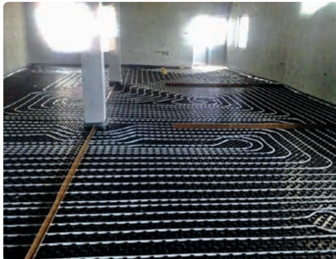
Podno grijanje u novoj obiteljskoj kući
