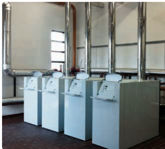
Uređaji ecoCRAFT u kotlovnici
