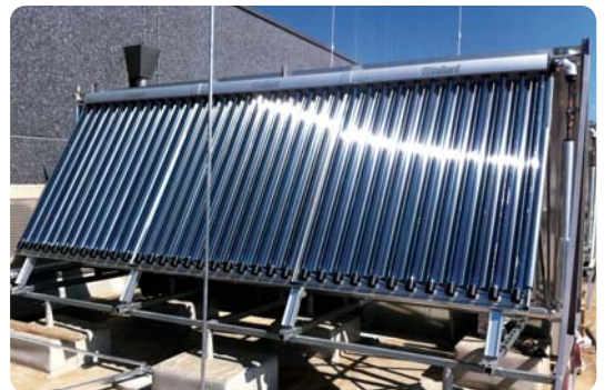
Instalirani vakuumski solarni kolektori
