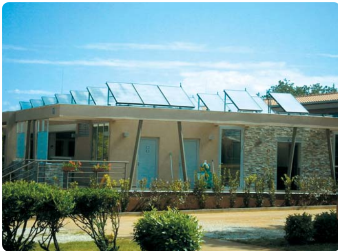
Kolektorsko polje na krovu zgrade
