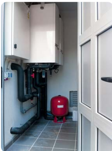
Pogled u kotlovnicu
