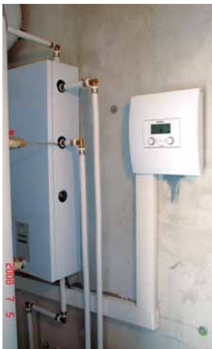
Objekt s apartmanima na otoku Pagu ima ugrađenu prvu solarnu stanicu u Hrvatskoj
