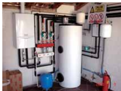
Kotlovnica obiteljske kuće u Zadru opremljena solarnim sustavom te rashladnikom vode Saunier Duval
