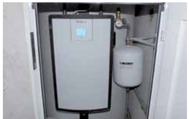
Solarna podstanica međuspremnika vile Vrbanj
