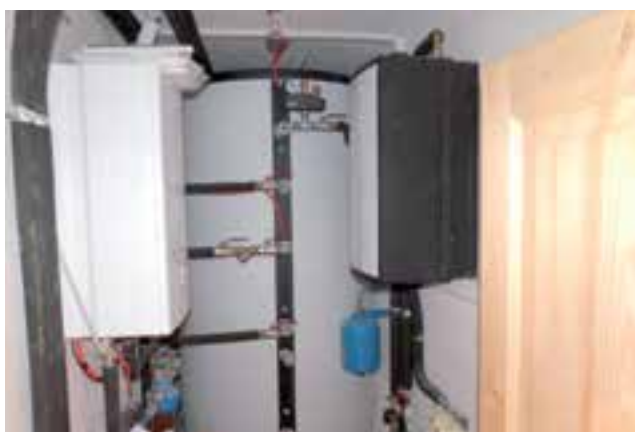
Kotlovnica vile u Vrbanju
