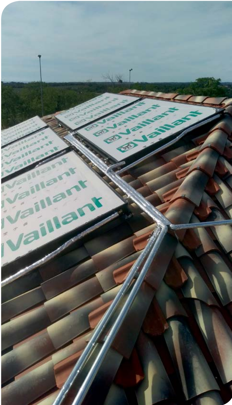
Šest pločastih solarnih kolektora auroTherm VFK 135/2 D raspoređenih u dva kolektorska polja
