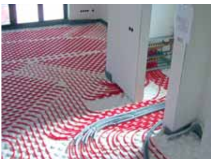
U kući je postavljen sustav za podno grijanje
