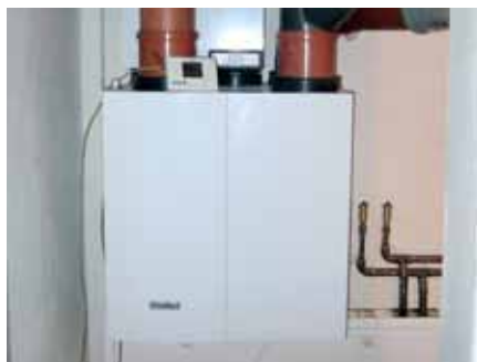
Osim toplinskom crpkom, objekt je opremljen i Vaillantovim ventilacijskim sustavom recoVAIR
