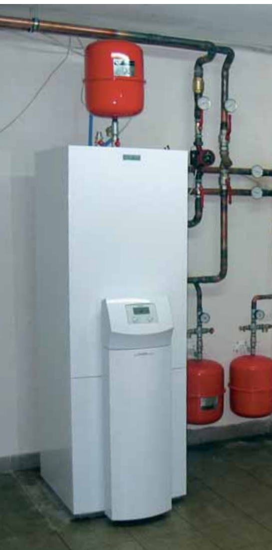
Sustav s toplinskom crpkom smješten je u urednoj kotlovnici
