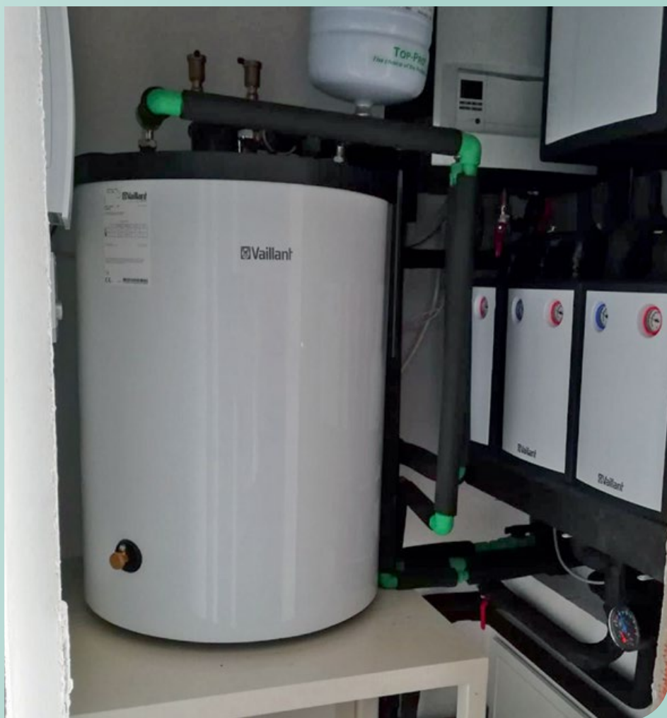
Mala kotlovnica velikog učinka
