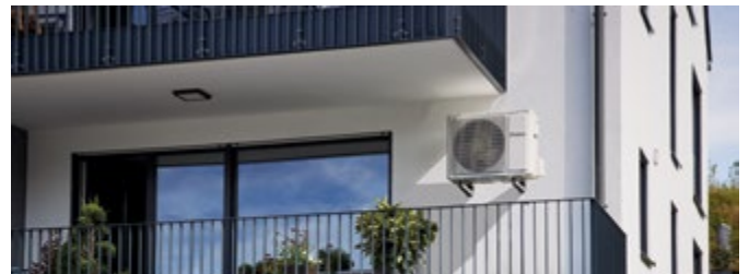
Vanjska jedinica postavljena na fasadu, na fasadne nosače; pristup za servisiranje s balkona.
