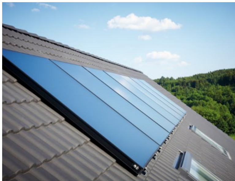
Pločasti kolektori montirani na kosi krov
