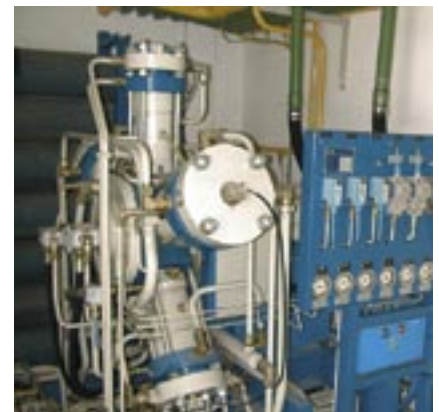
Plinski motor i kompresorsko postrojenje punionice stlačenog prirodnog plina Gradske plinare Zagreb
